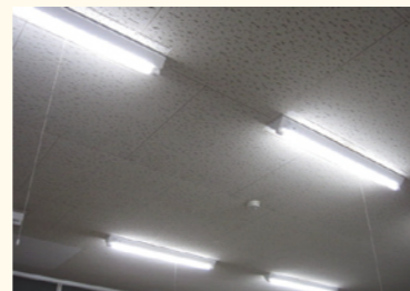
LED照明(事務所)
