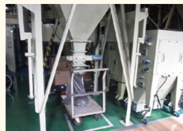
集塵機(パッド研磨工程)
