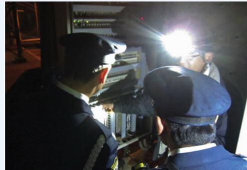
ライトを点灯して電源を操作
