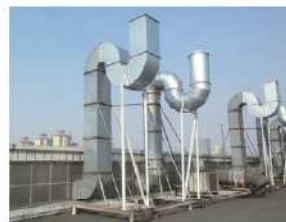
屋外排気ダクト(対策後)
